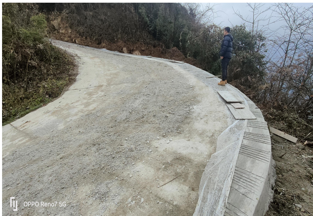
(民主村生态宜居建设——损坏道路治理)
